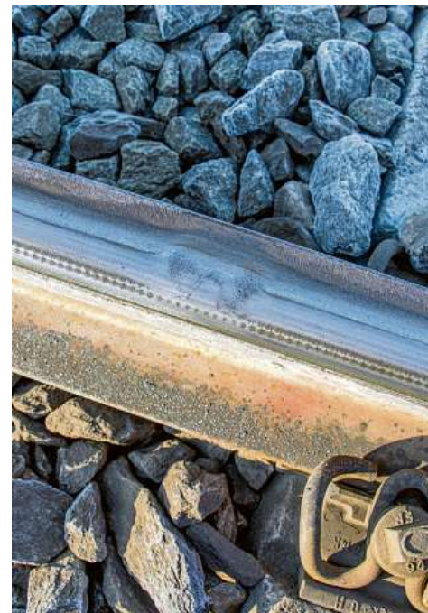
Ist dieser kleine Schaden gravierend?
